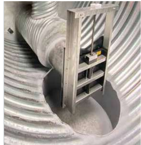
Vanne de confinement (ouvrage 100% D9A)
